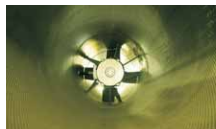
System wyciągu powietrza o mocy 110 kW
